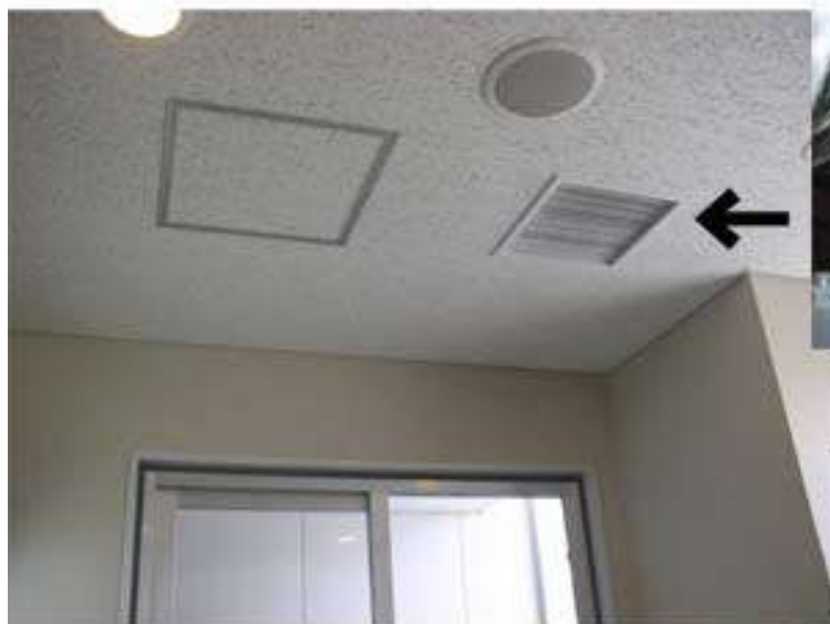
天井に排気口
